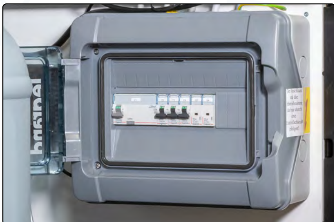
FI & Sicherungen ausschalten
