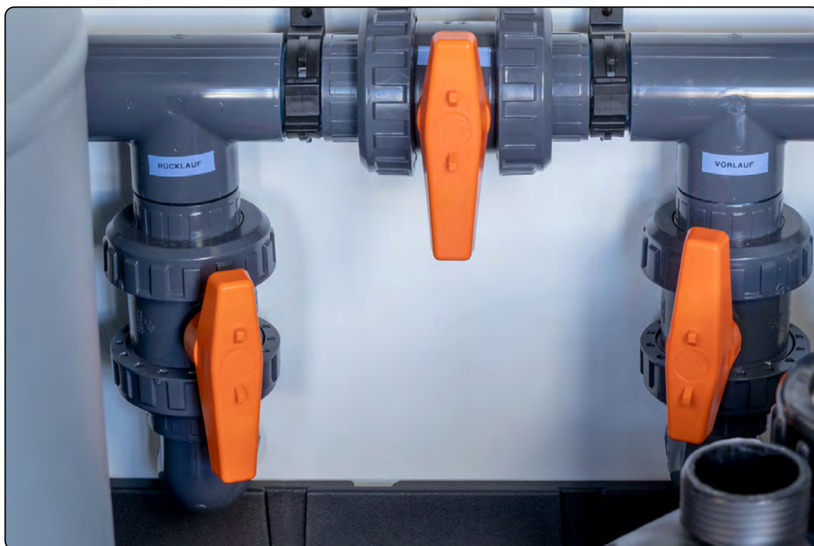
Heizungsbypass geschlossen / Vor- und Rücklauf geöffnet
